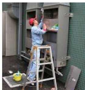
脱臭装置メンテナンス
